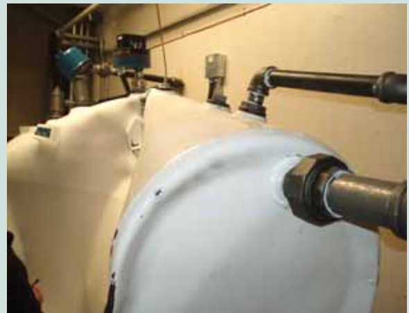
Réservoir auxiliaire de mazout après implosion.
